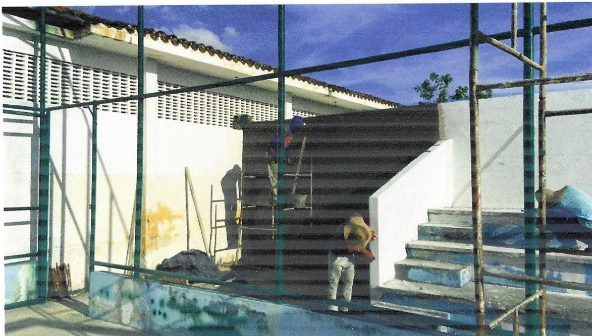
Foto 05- MASSA ÚNICA, PARA RECEBIMENTO DE PINTURA OU CERÂMICA, ARGAMASSA INDUSTRIALIZADA, PREPARO MECÂNICO, APLICADO COM EQUIPAMENTO DE MISTURA E PROJEÇÃO DE 1,5 M 3 /H EM FACES INTERNAS DE PAREDES, ESPESSURA DE 5MM, SEM EXECUÇÃO DE TALISCAS. AF_06/2014
