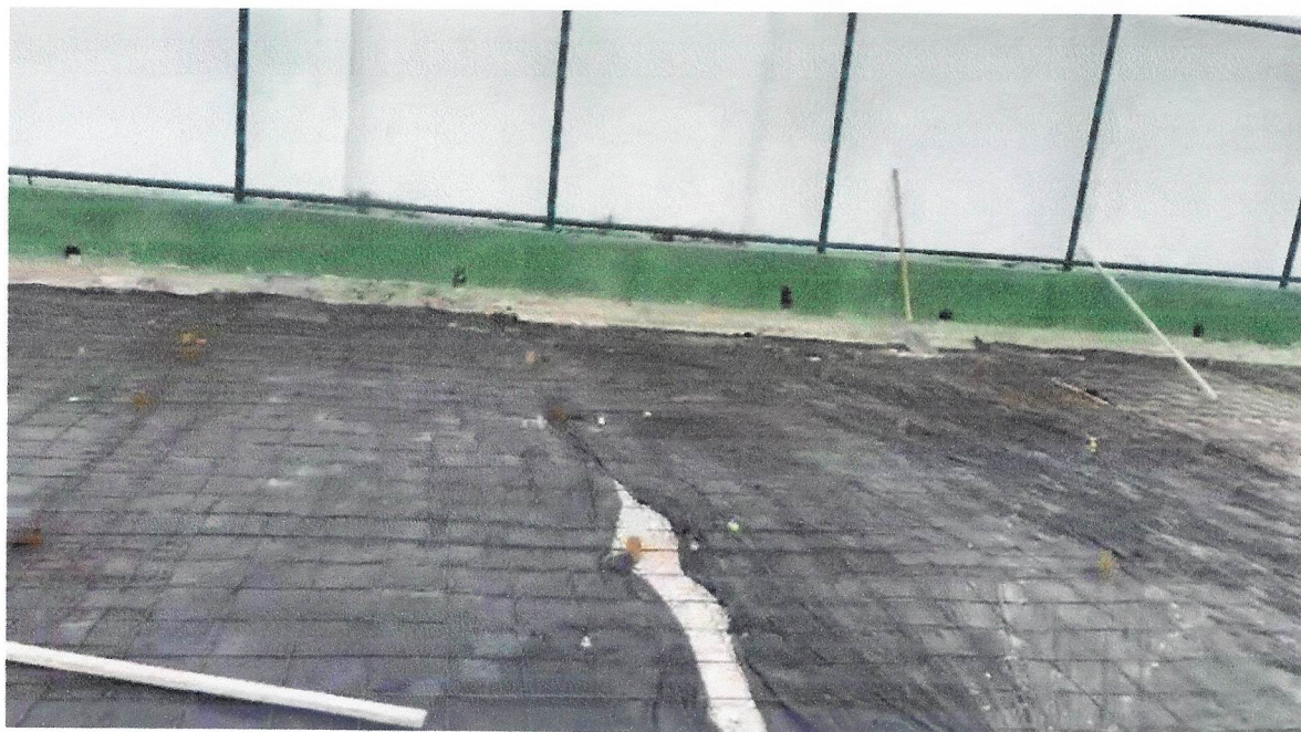
Foto 08- Fornecimento e instalação de tela aço soldada nervurada CA-60, malha 15x15cm, ferro 4.2mm, painel 2x3m, (1,50kg/m 2 ), Malha Pop Reforçada Gerdaud ou similar
